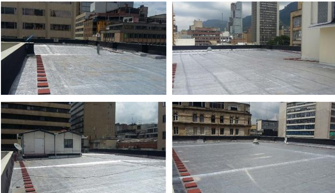
Imagen No.10 Título: Estado de la Terraza del Edificio Pedro A. López Luego de ser Intervenido. Fuente: Subdirección Administrativa-Grupo de Servicios Administrativos
