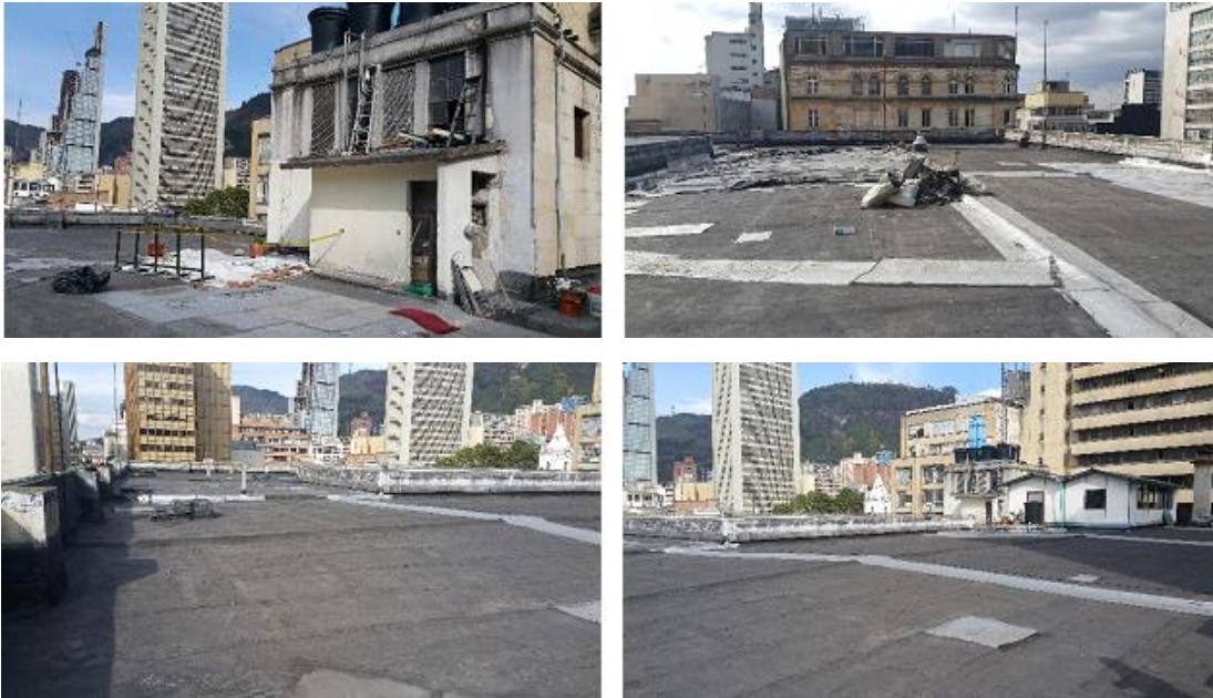
Imagen No.9 Título: Estado de la Terraza del Edificio Pedro A. López Antes de ser Intervenido. Fuente: Subdirección Administrativa-Grupo de Servicios Administrativos.
